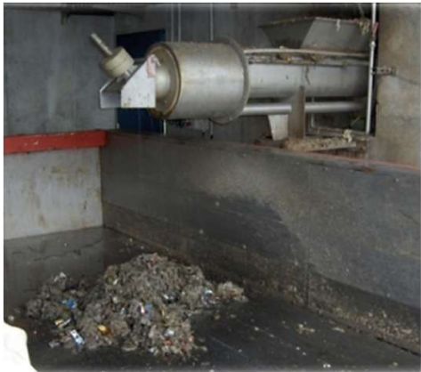
Refus de dégrillage - STEP principale de Limoges
