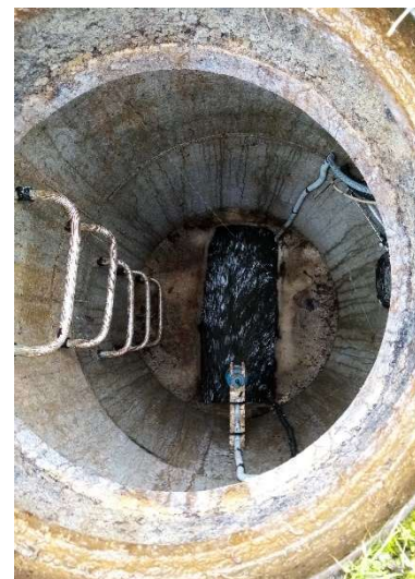
Débitmètre Hauteur / vitesse – STEP Rive Gauche
